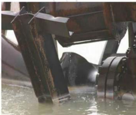
تصویری از فلنج مرتبط با واشر عایق در لحظاتی که هنوز حریق ناحیه میترینگ به طور کامل اطفاء نشده است. همانگونه که در تصویر مشخص است هیچ گونه آثاری از واشر فلزی بر روی پیچ و مهره ها وجود ندارد
